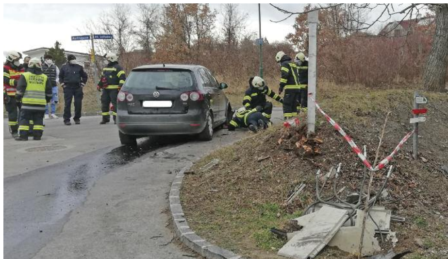
Vollkommen zerstört wurde ein Internet-Verteilerkasten bei einem Verkehrsunfall in der Martinigasse. Der Lenker blieb unverletzt.
